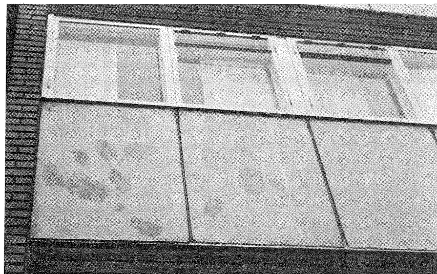
Nærbillede af fig. 1. Poreproblemet optræder ikke kun ved betonflader, som skal males eller tapetseres, men også, som her, ved »synlig beton«, når porerne er koncentreret i pletter.
